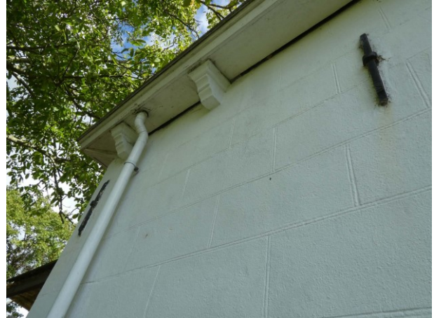
Figuur 34 Schone muur onder de dakgoot
