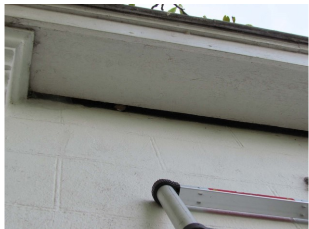
Figuur 24 Opening aan de onderzijde van de dakgootbetimmering
