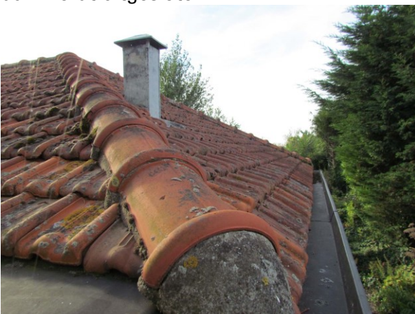
Figuur 17 Strak liggende dakpannen zonder ruimte
