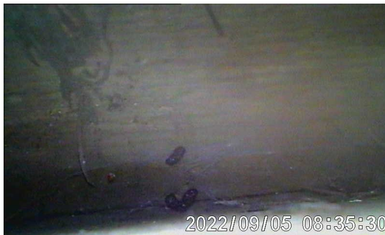
Figuur 26 Foto gemaakt met een endoscoop van twee uitwerpselen van vleermuizen in de betimmering om de dakgoot
