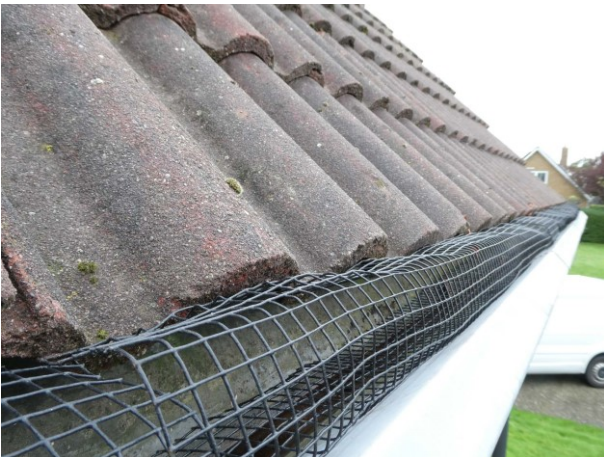
Figuur 13 Vogelwerende maatregelen in de dakgoot
