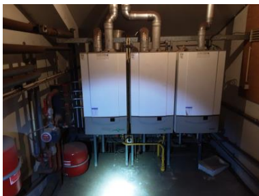
Niet asbestverdacht : Cv-ketels
