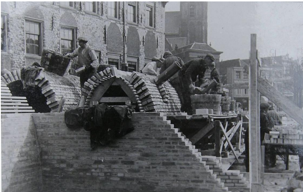
Afb. 22. De bouw van de schuilkelder bij de westgevel. Bron: Historische Vereniging Die Goude, nieuwsbrief 85-november 2016.
