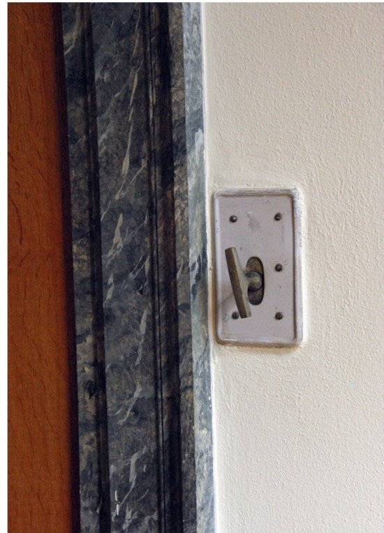
Afb. 69 Bedieningsknop naast de deur van de burgemeesterskamer (2.07) naar de trouwzaal. De functie van de knop is niet duidelijk.
