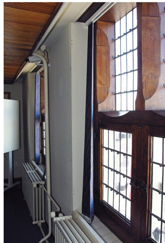
Afb. 111 Detail kozijn uit de tijd van de restauratie. Aan de voorzijde, net boven de verwarming, is een deel van het stalen raamwerk zichtbaar waarin zo nodig stalen luiken konden worden aangebracht.
