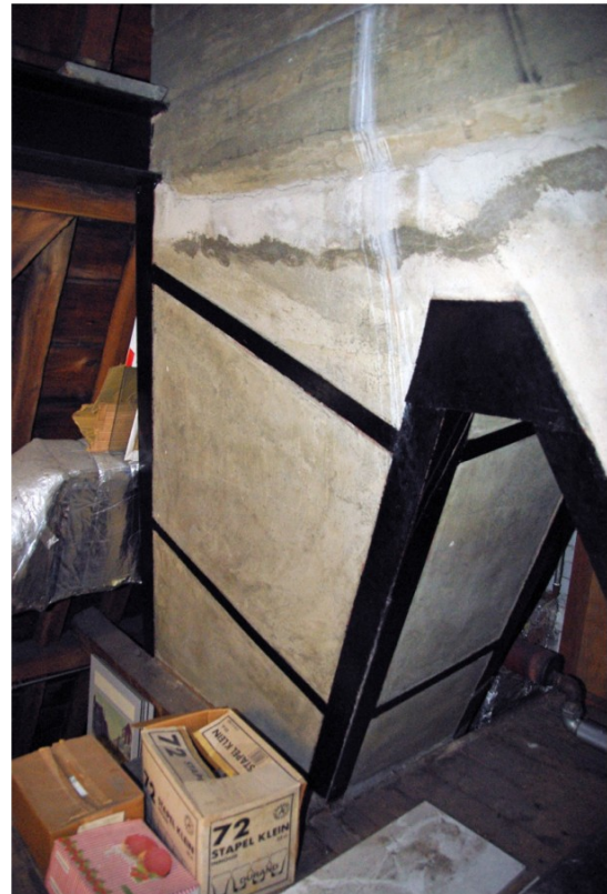
Afb. 116 Detail ter hoogte van het tweede juk met de wigvormige bokconstructie waarop twee gesleepte schoorsteenkanalen samenkomen in één schoorsteen.
