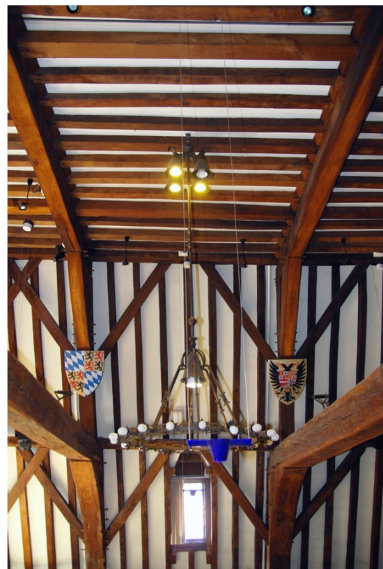
Afb. 102 Travee van de raadzaal (4.01) waaraan te zien is dat de zolder op het eerste juk is verwijderd en op het tweede juk is aangebracht, waardoor een hogere ruimte verkregen is.
