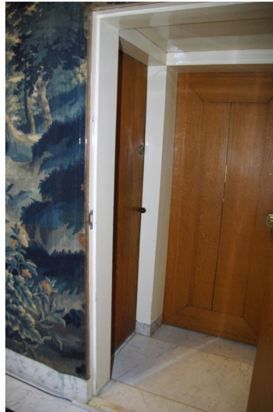
Afb. 62 Portaaldoorgang van de trouwzaal (2.06) naar de burgemeesterskamer (2.07) met links deur naar wc.
