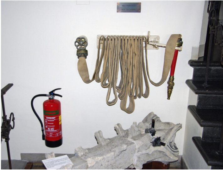
Afb. 81 Bij de hoofdtrap (3.02) bevindt zich een uit de tijd van de restauratie daterende droge brandleiding met –slang en –spuit. Op de grond één van de bij de restauratie van 1996 vervangen pinakels.
