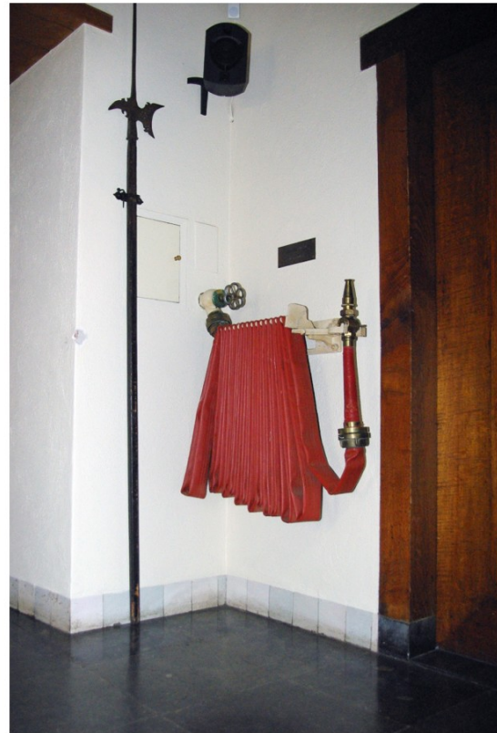
Afb. 106 Deel hal (4.02) met hellebaard geschonken door de afdeling Gouda der Centrale vereniging voor de Markt-, Straat- en Rivierhandel. Daarnaast een van de restauratie daterende droge brandleiding met slang en spuit.
