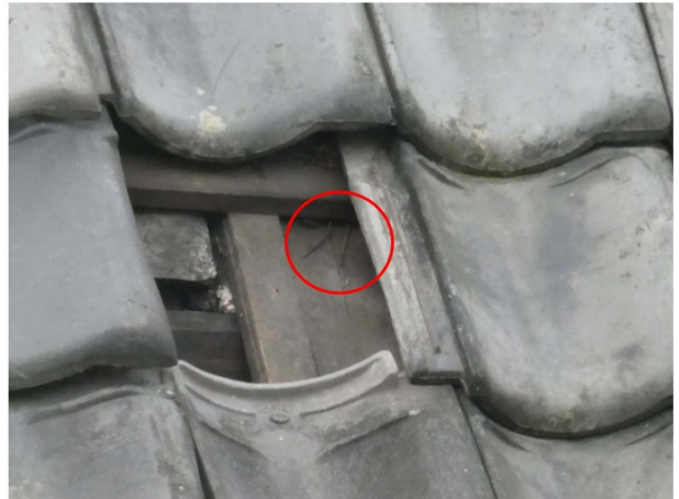
Figuur 10 Missende dakpan met takken
