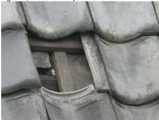
Figuur 1, missende dakpan met takken
